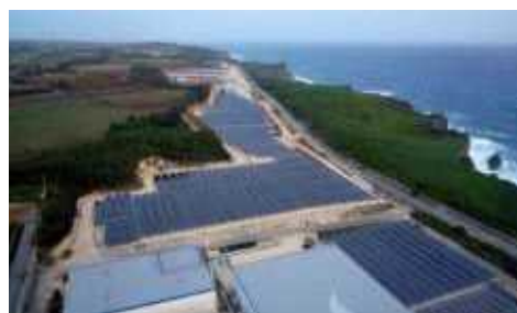
(出典:沖縄新エネ開発株式会社) 宮古島メガソーラー実証研究設備 (実証実験は2013年度で終了しています)
